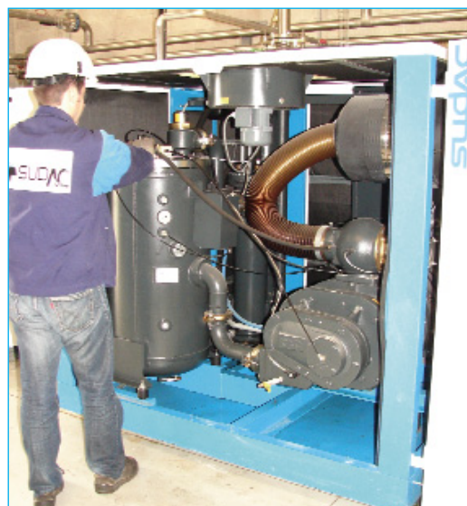
Intervention sur centrale SUDAC
